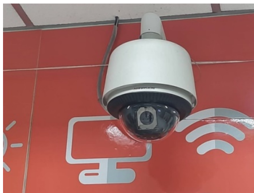
รูปที่ 3.6 กล้องวงจรปิดแบบหมุนปรับมุมและควบคุมได้
