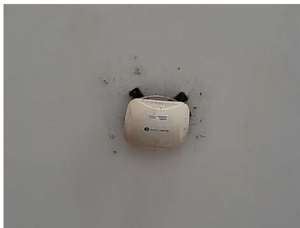
รูปที่ 5.38 Access Point ยี่ห้อ Alcatel
