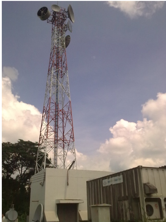
รูปที่ 8.13 จานไมโครเวฟบนเสาสัญญาณ
